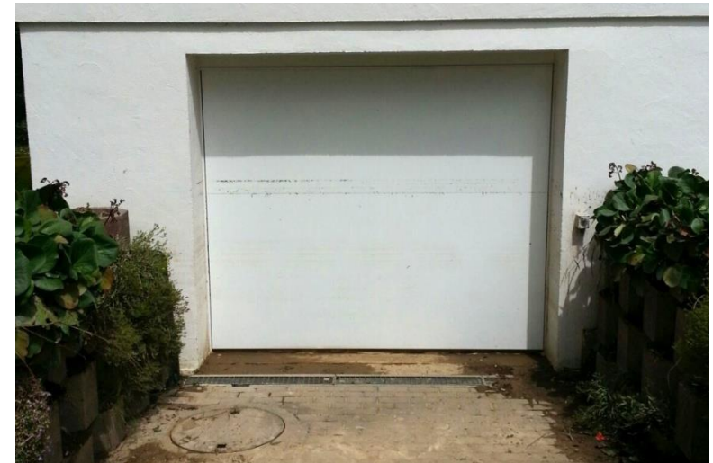
Nach dem Hochwasser
